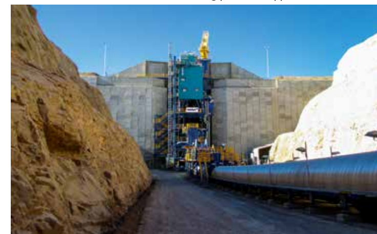
7.250 t/h semi-mobile Brecheranlage für Kupfer in Chile 7,250 t/h semi-mobile crushing plant for copper in Chile
